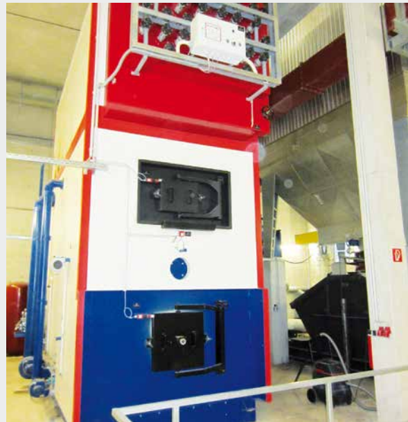
Foto: BayWa Energie Dienstleistungs GmbH
